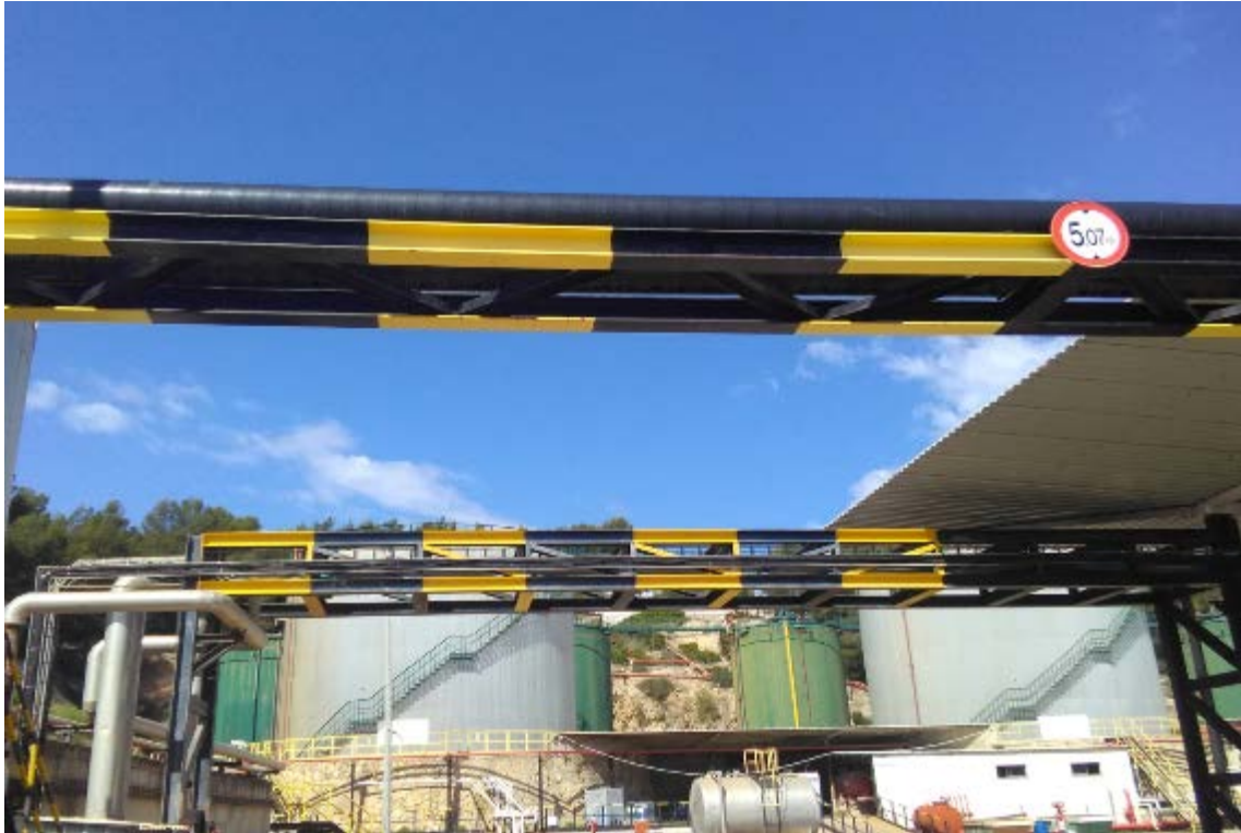
Fotografía 11. Rack tuberías (No se desmantela)
