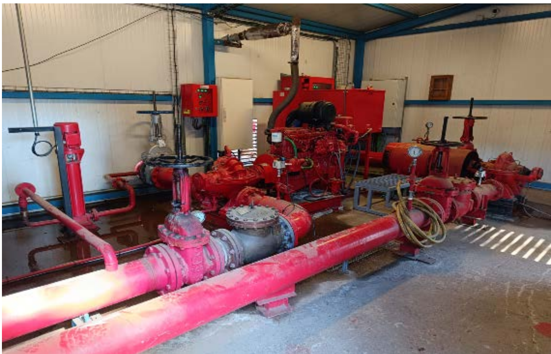
Fotografía 42. Bombas DCI (No se desmantela)
