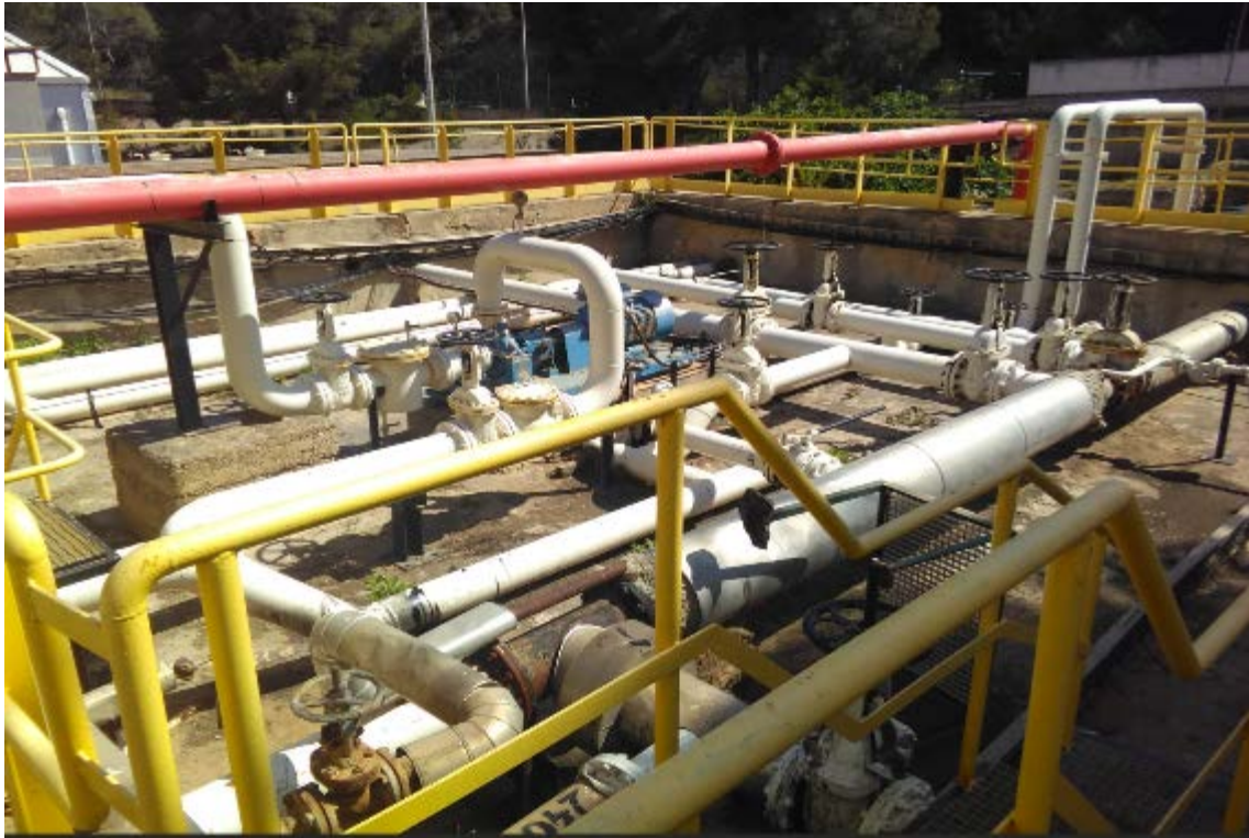
Fotografía 17. Área bomba MBRC-02 y tuberías
