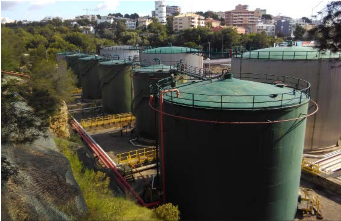
Fotografía 33. Vista general tanques de almacenamiento
