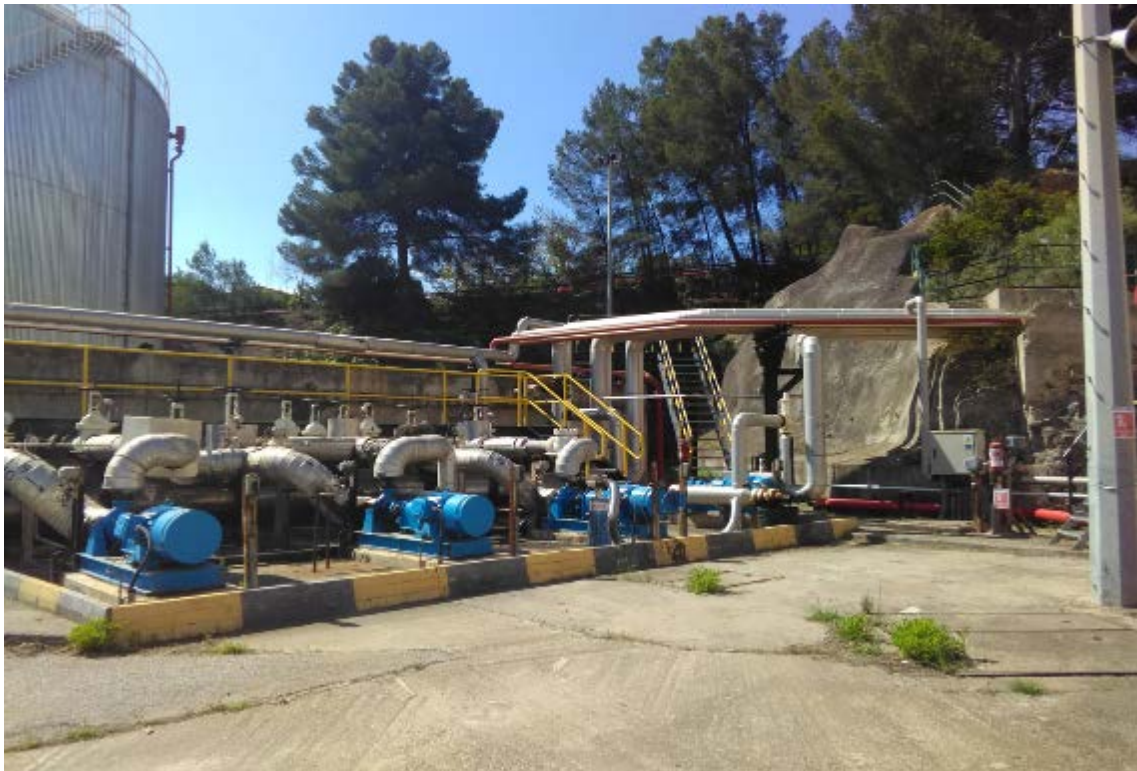
Fotografía 13. Estación bombeo EE/BB Nº 1
