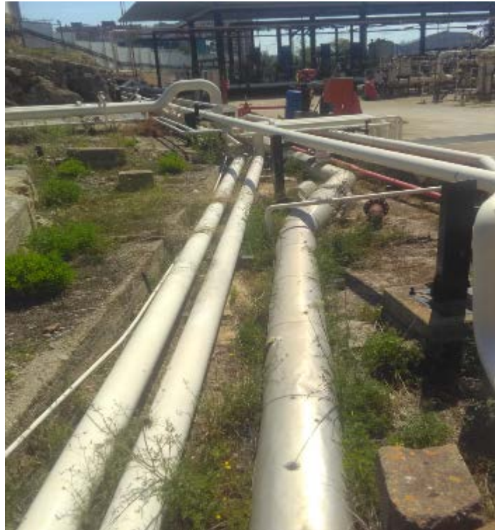
Fotografía 23. Tuberías poliducto (No se desmantela)
