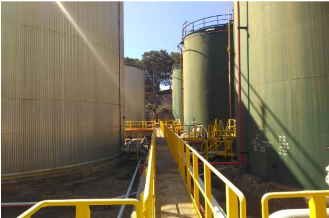
Fotografía 16. Pasarelas área tanques de almacenamiento
