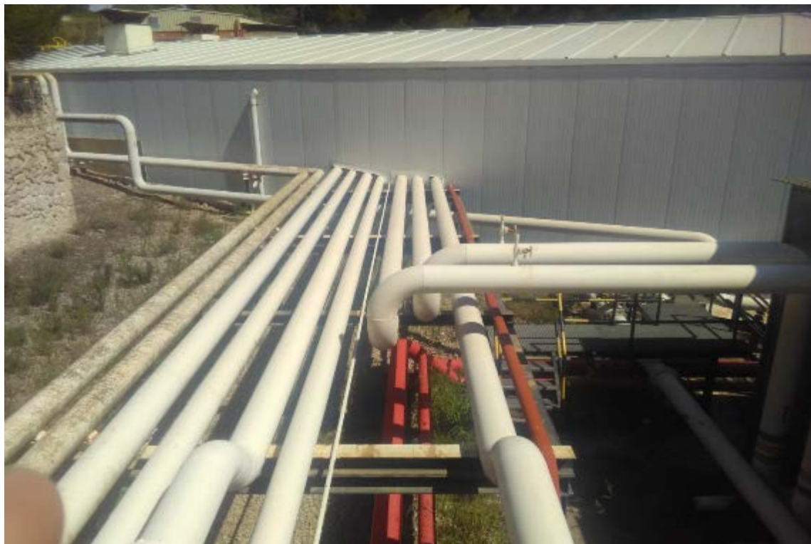
Fotografía 20. Tuberías entrada estación de bombeo del poliducto
