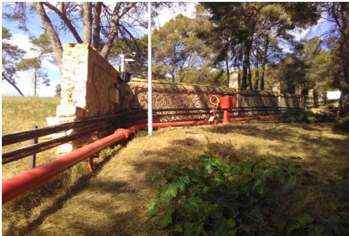
Fotografía 6. Instalaciones contra incendios (Se desmantela parcialmente)
