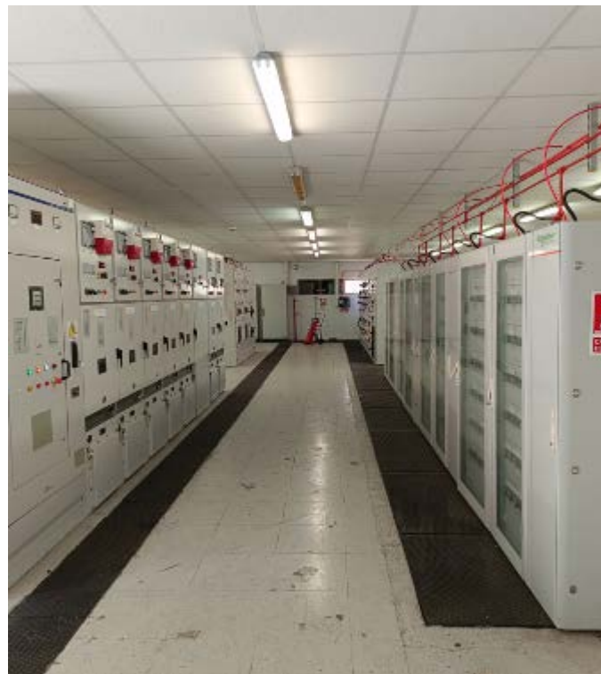
Fotografía 38. Centro de Control de Motores (CCM) (No se desmantela)
