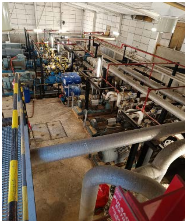
Fotografía 40. Estación bombeo poliducto (No se desmantela)
