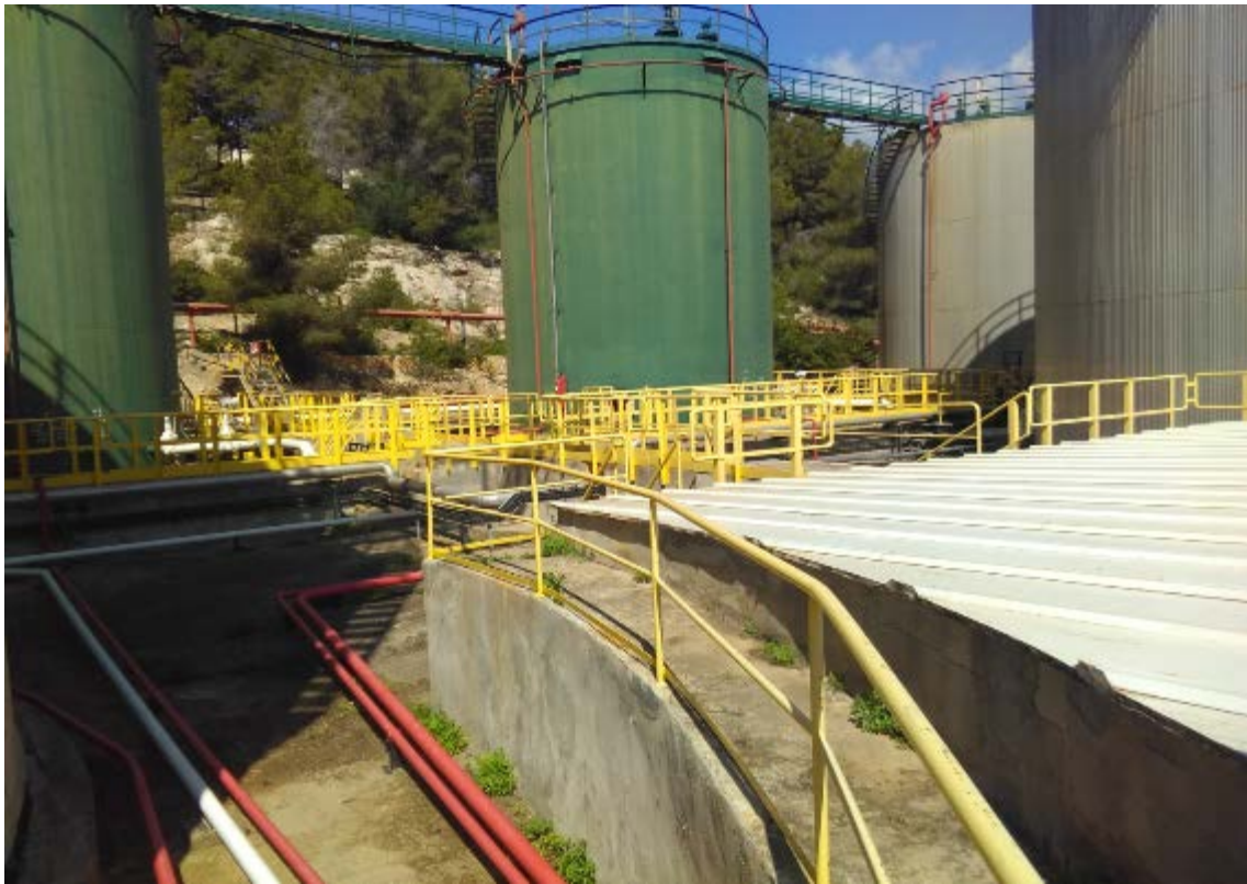
Fotografía 15. Área Tanques de almacenamiento
