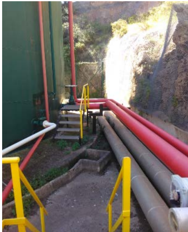
Fotografía 19. Tuberías alimentación agua a depósito agua contra incendios (No se desmantela)
