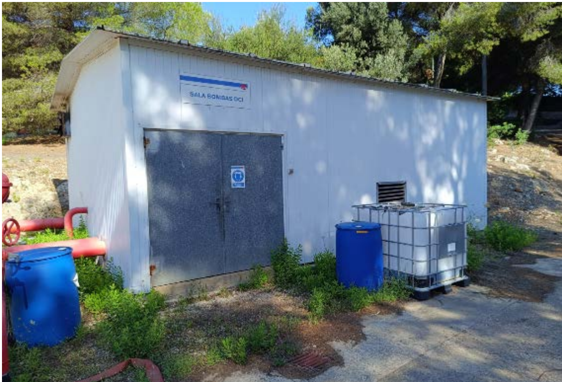
Fotografía 41. Sala bombas DCI (No se desmantela)
