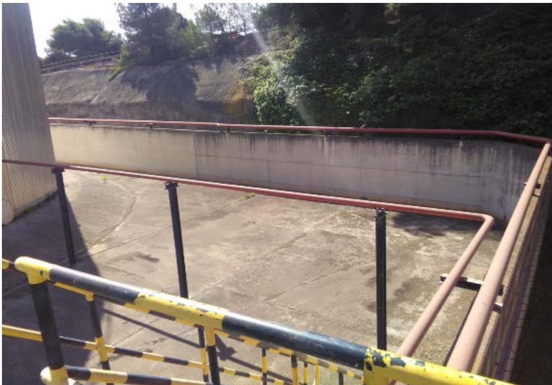
Fotografía 14. Cubeto tanque T-010
