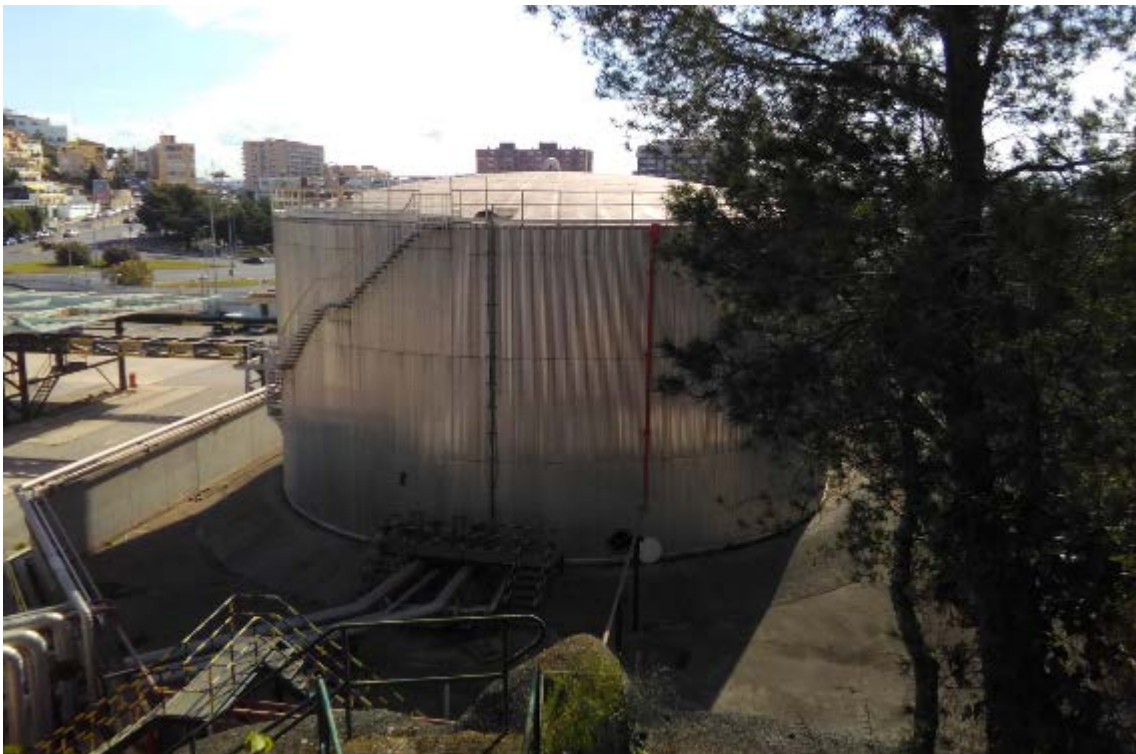
Fotografía 34. Tanque de almacenamiento T-010
