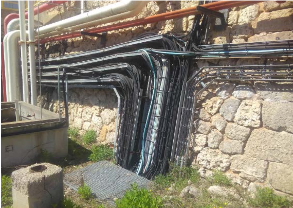
Fotografía 21. Cables eléctricos y de instrumentación
