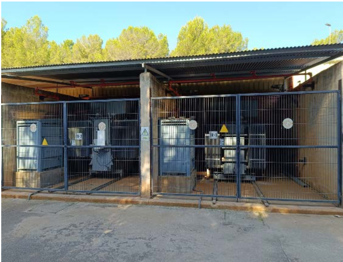
Fotografía 36. Transformadores (No se desmantela)
