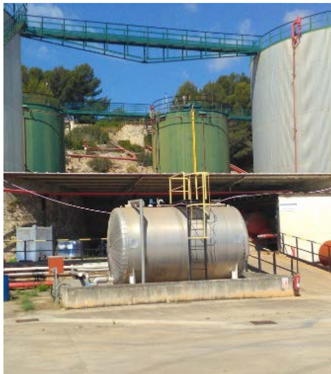
Fotografía 12. Tanque purgas Fuel Oil y tanques de almacenamiento al fondo
