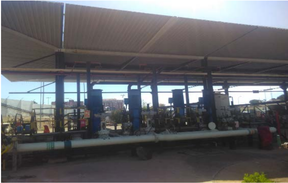
Fotografía 25. Estación bombeo EE/BB N°2 (No se desmantela)
