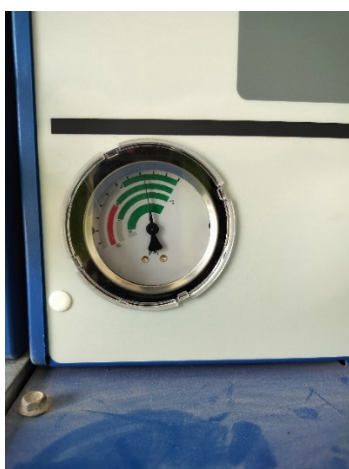
Manómetro indicador del nivel del Gas SF 6
