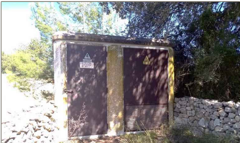
Punto de conexión de la línea de evacuación
