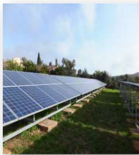
Placas solares en Es Fangar, S.A
