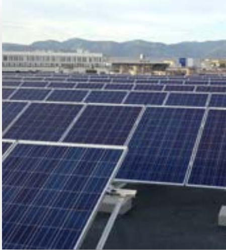
Placas solares en De Salabert e Hijos, S.A.
