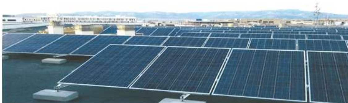
Imagen de las placas solares instaladas en la empresa Salabert e Hijos, S.A.
