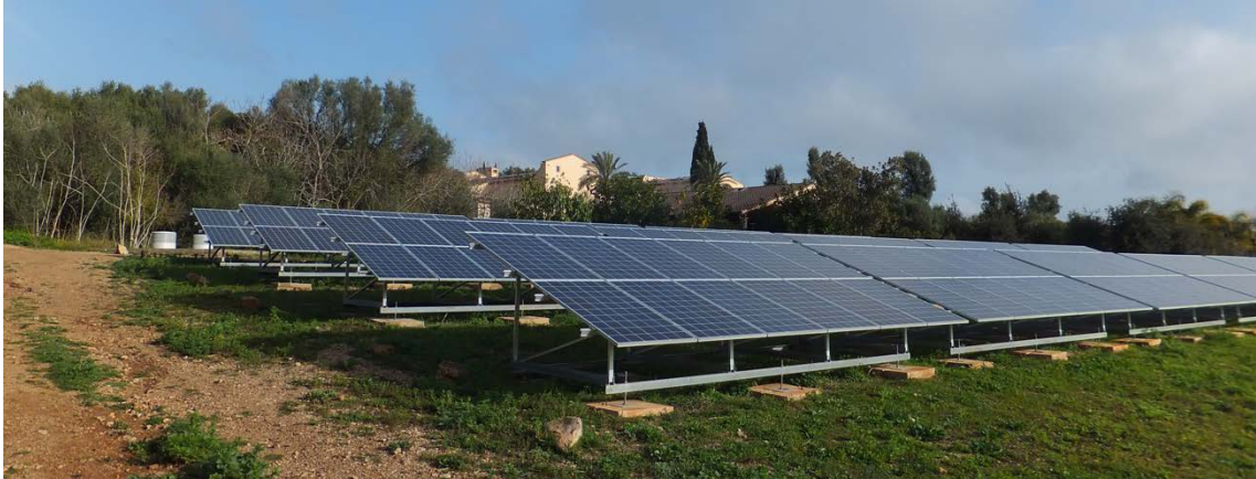
Imagen de las placas solares instaladas en la empresa Finca Es Fangar, S.A.
