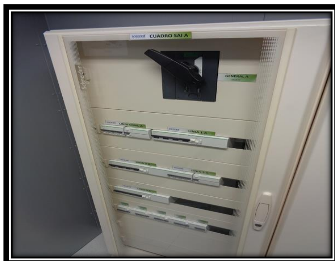
Imagen de las Instalaciones del Centro de Proceso de Datos
