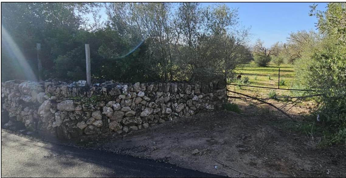
ILUSTRACIÓN 22 ESTADO ACTUAL CERRAMIENTO Y ACCESO
