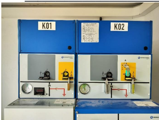
Cubas de gas instaladas en un CT (Centro Transformador).
